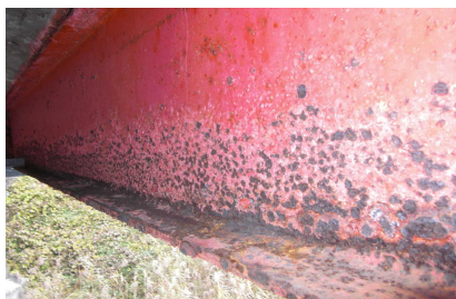
「防食機能が劣化した状態」
