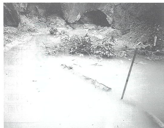
ずい道の被害状況
